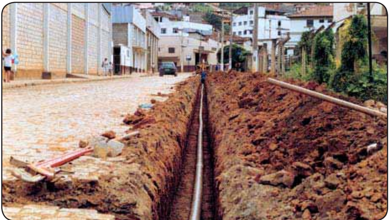
Foto 6 — Rede de distribuição em PVC PBA
